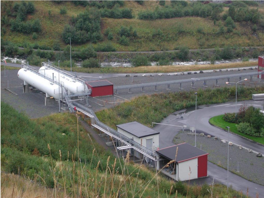
Bilde 3. LPG-anlegg og fyllestasjon for LPG i Øvre Årdal. Fordamperstasjonen skimtes i bildets høyre bildekant.
